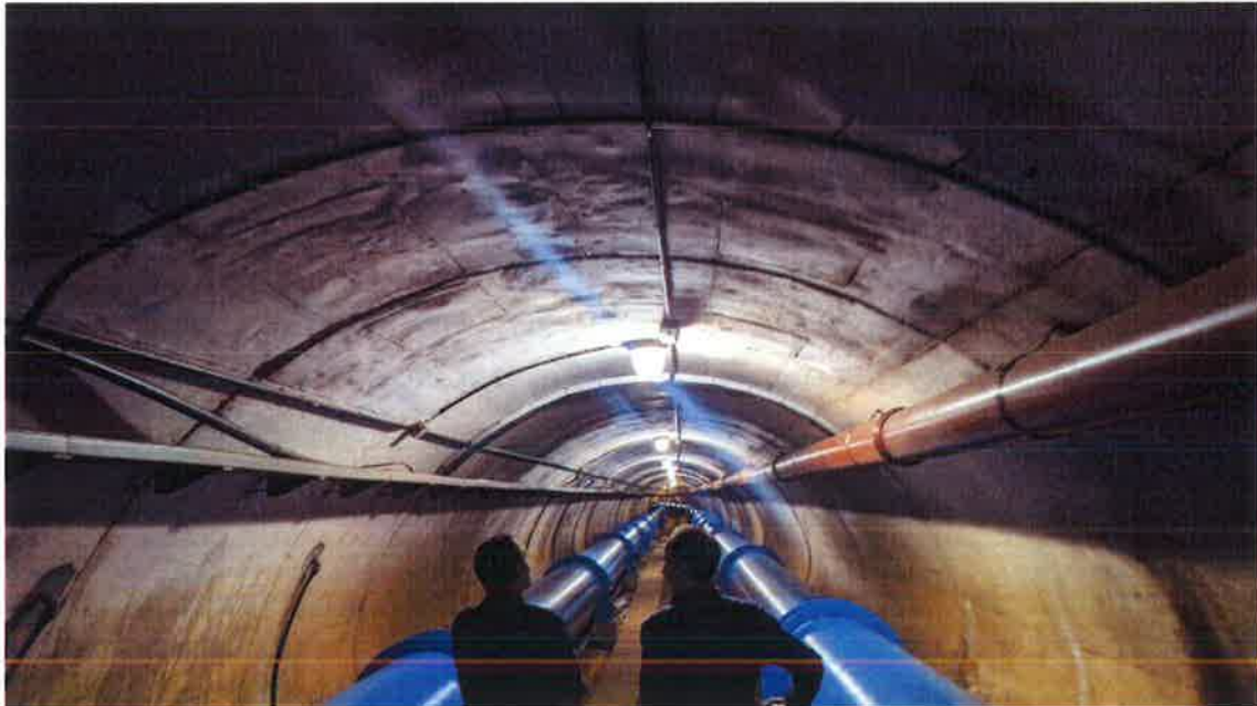
Interior del túnel de la presa de Úzquiza en el que se observa la bandeja existente.
