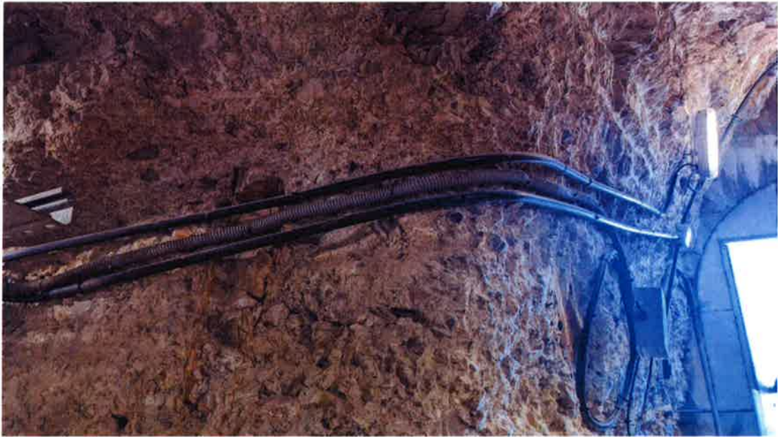
Punto de salida de la fibra óptica en bandeja a canalización soterrada existente.
