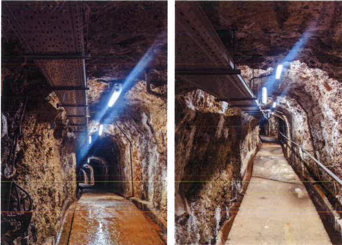
Vista de las galerías interiores y de las bandejas existentes.
