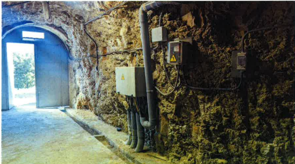
Caja de entrada a las galerías de la presa de Arlanzón para discurrir posteriormente por bandeja.
